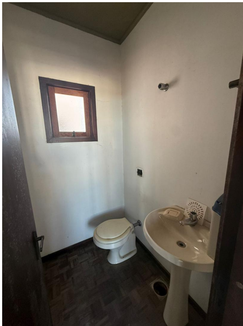
Foto 7: sala 42 - banheiro Fonte: Carvalho Lira Engenharia, 2026
